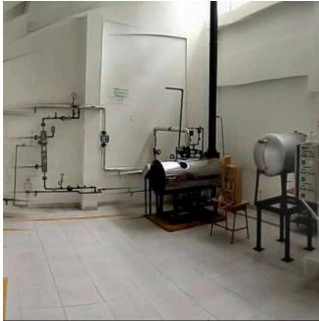
Imagen No 1 Caldera del Laboratorio de Plantas térmicas.
